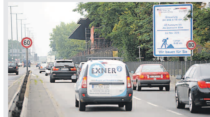
Im Rahmen der Sanierung an der AVUS könnten die geforderten Lärmschutzwände mitgebaut werden. Foto: Hahn
